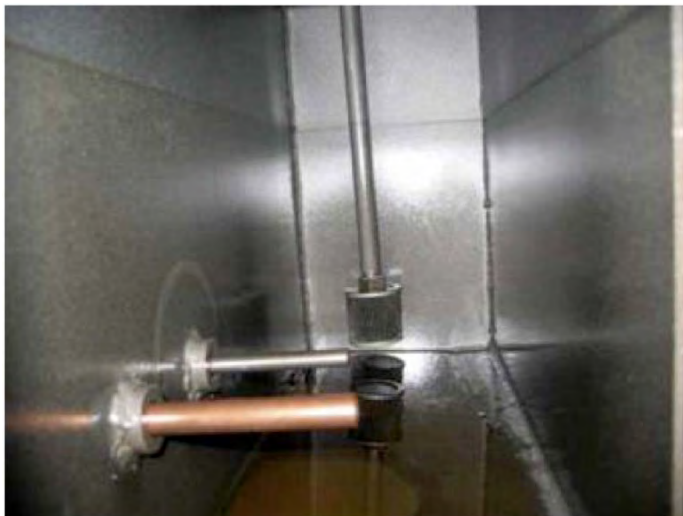
図4-26 三河アクロス No.1 の潤滑油タンク内部の状況
